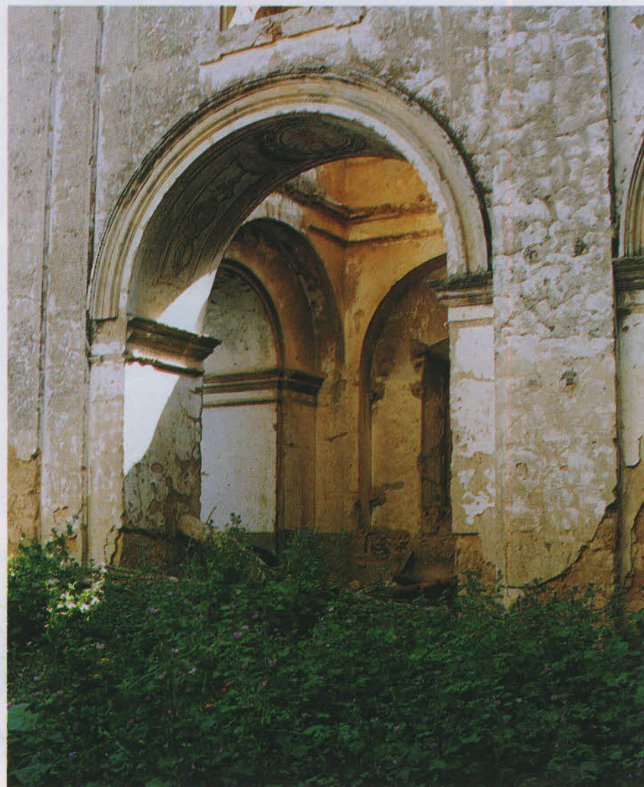
Interiores del Convento, estado actual de los arcos y las paredes.
